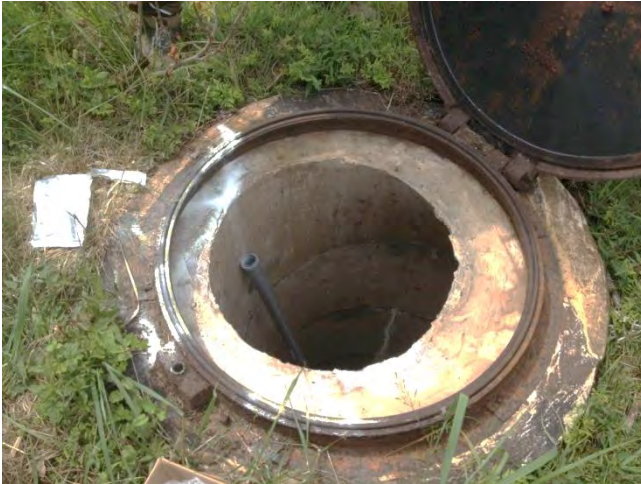
Abbildung 1: Trinkwasserbrunnen mit Chemikalienbeutel und PVC-Rohr
