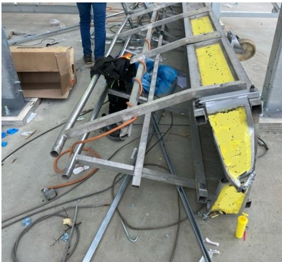
Abbildung 1: Die Arbeitsbühne nach dem Absturz aus 36 Meter Höhe!
