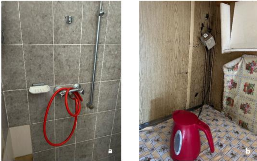
Abbildung 3 a und b: Negativbeispiele für Instandhaltungsmaßnahmen.
