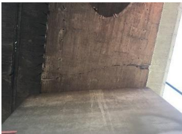
Abbildung 2: Brückenschäden neben dem Pfeiler, auf dem das Rollenlager kollabierte
